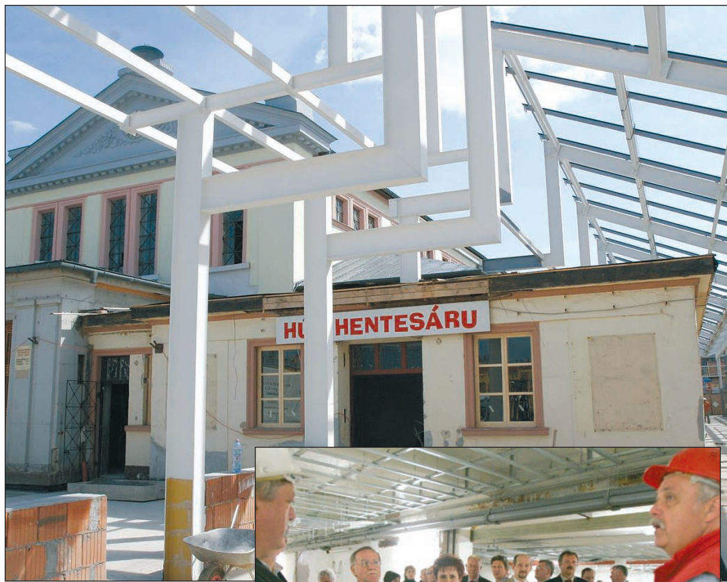
Régi és új – a vásárcsarnok műemlék épületét jól kiegészíti a modern üvegezett tető.
