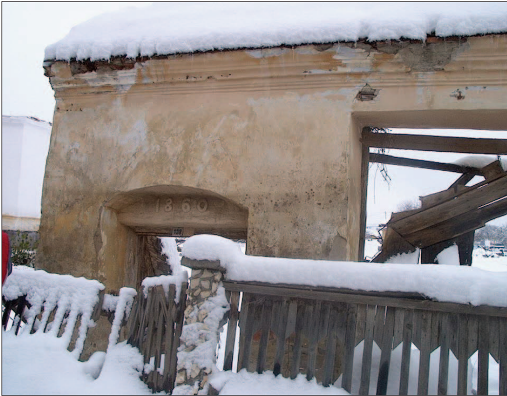
Romba dőlt épület Nyikómalomfalván.
